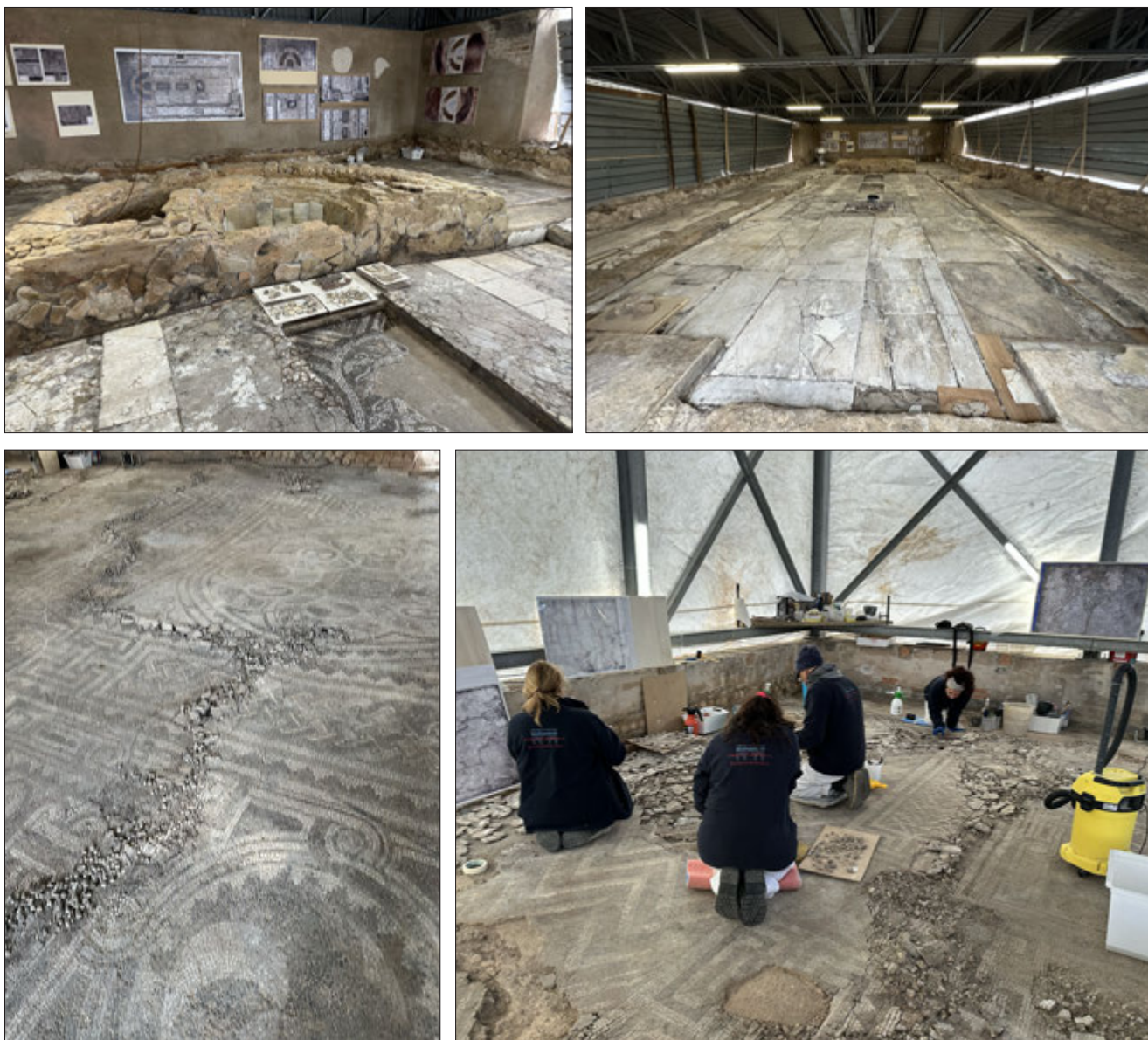
14. - I recenti interventi di restauro dei mosaici delle terme e dei marmi della cenatio , dopo l'incendio del 2017, funzionali alla nuova musealizzazione (foto Giuliano Volpe).
